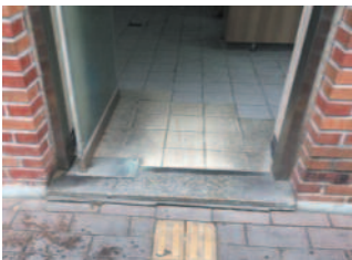
장애인화장실이 별도로 없음에도 불구하고 턱이 높고, 문이 좁음(대림 어린이공원)
